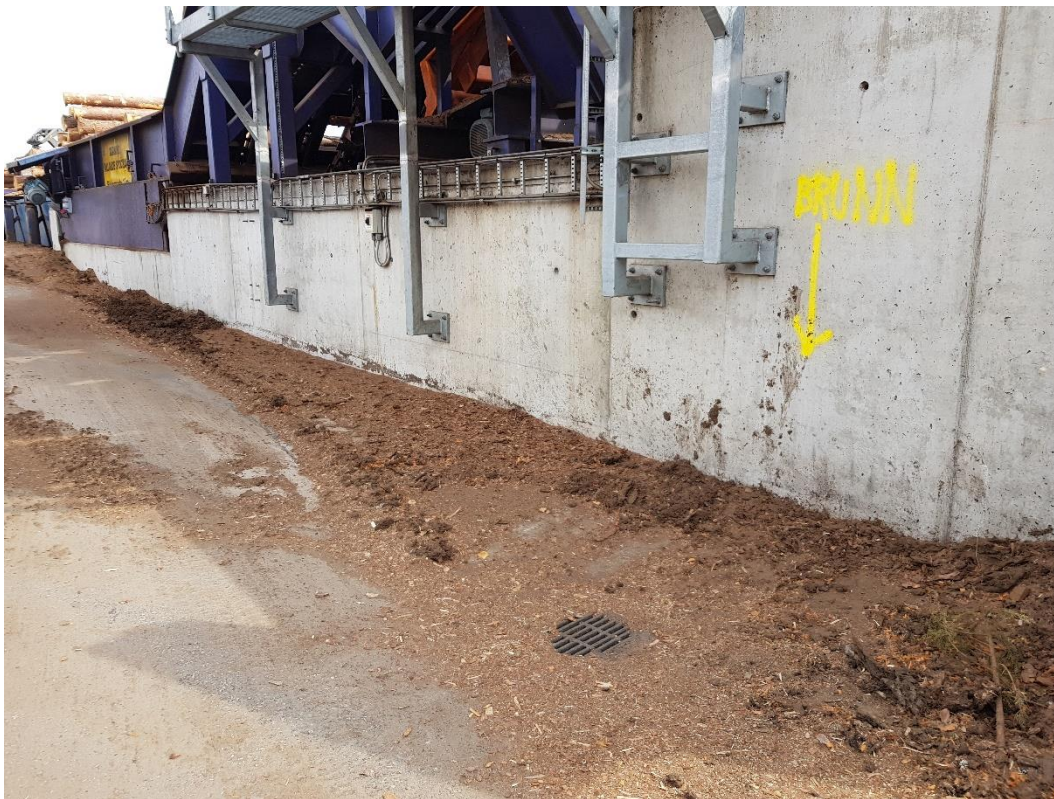
Figur 5. Dagvattenbrunn i den centrala delen av timmerplanen.
