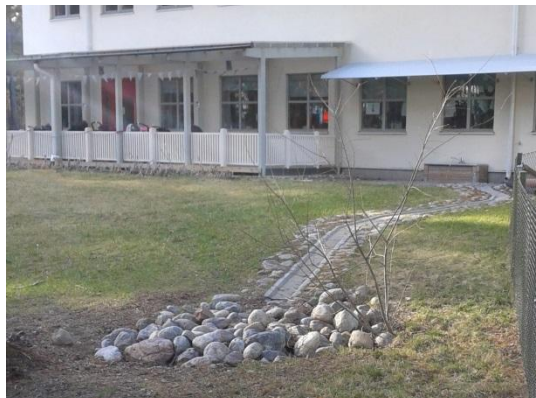
Figur 17. Ränna från stuprörsutkastare (Bild: WSP, Gävle)
