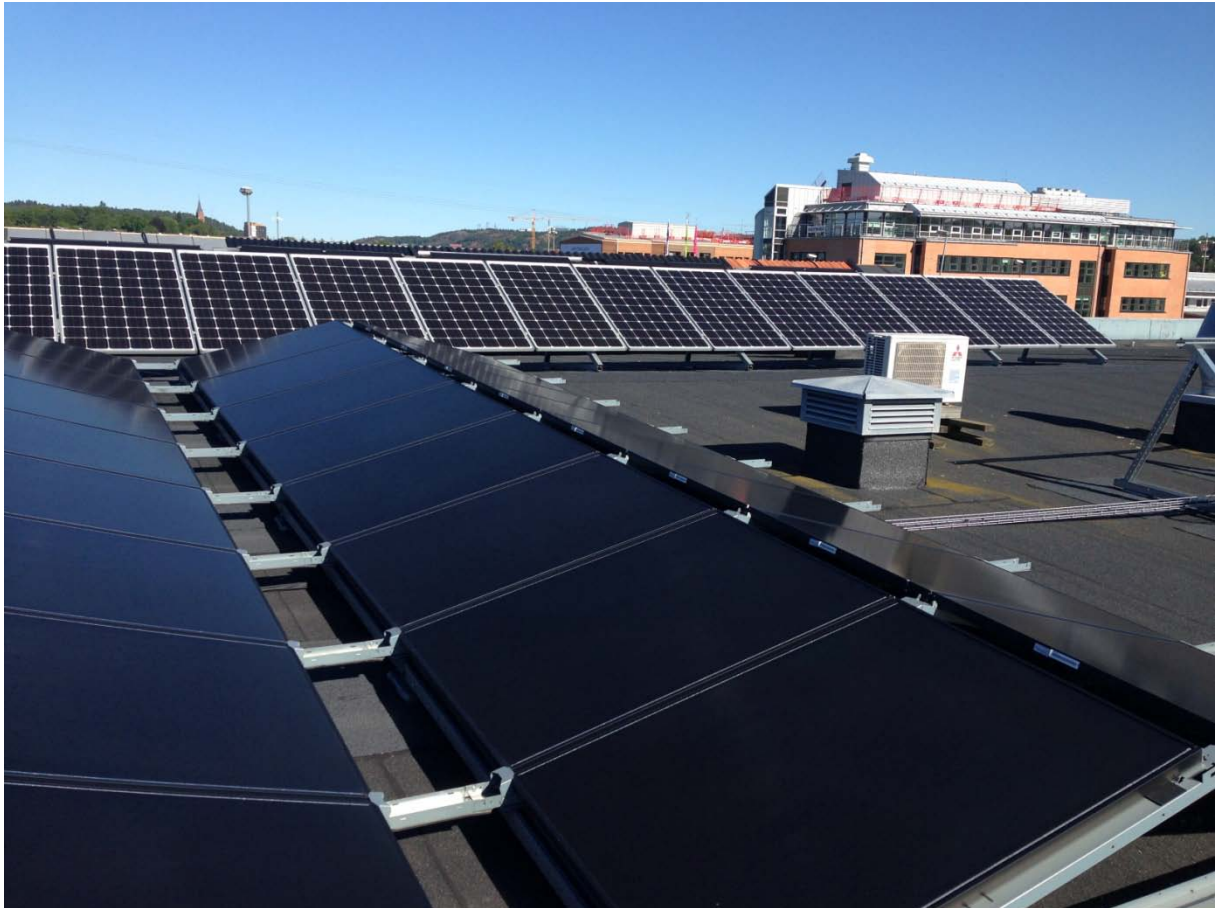
Solcellsinstallation i Mölndal Foto: Mölndal Energi
